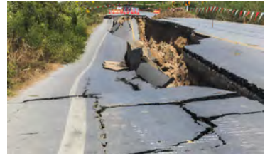
Deprem sonrası yolun görünüşü
