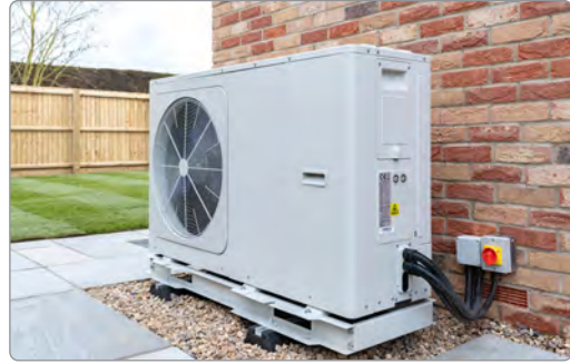
Isı pompası sisteminin dış ünitesi
